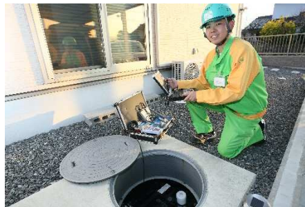
浄化槽の維持管理
